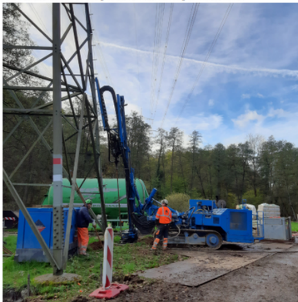
Abb. 1. Geräteeinsatz am BV Eiberg-Opladen am Mast 113. Fotograf Andreas Richter.
